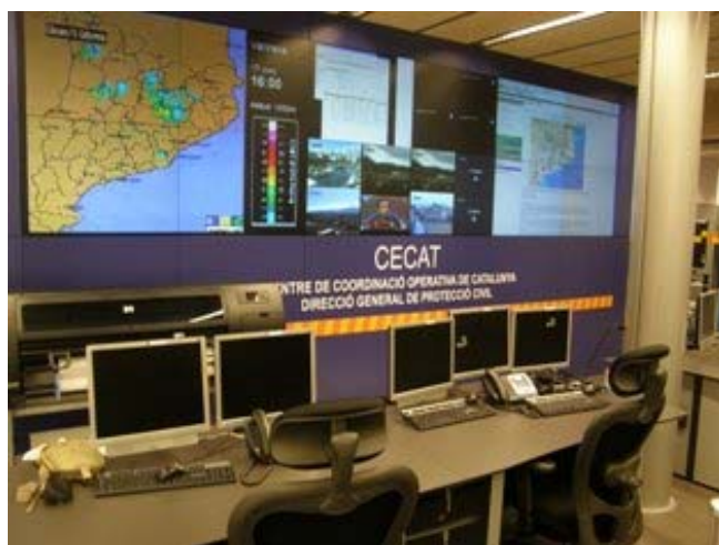
Imatge de la sala de guàrdia del nou CECAT
