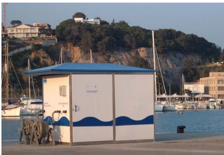
Mòdul instal·lat al port d'Arenys de Mar
