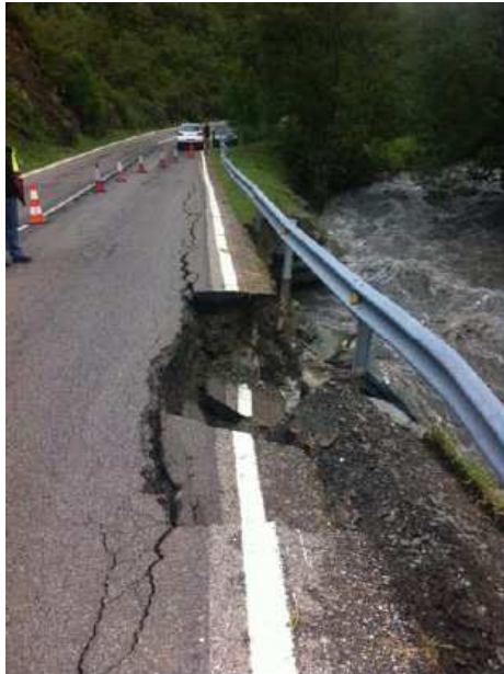
Afectació a l'L500 a Llesp
