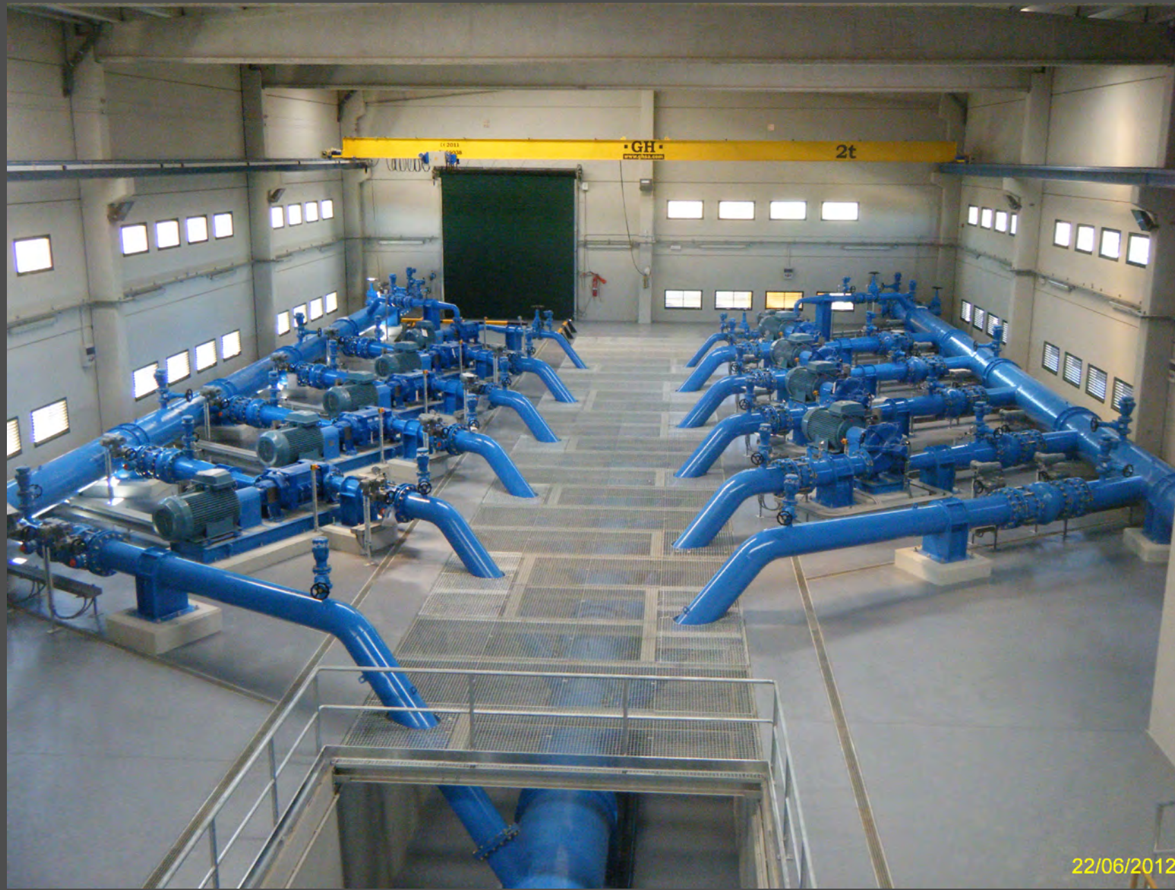
Sector 10-11-14. Estació Bombament.
