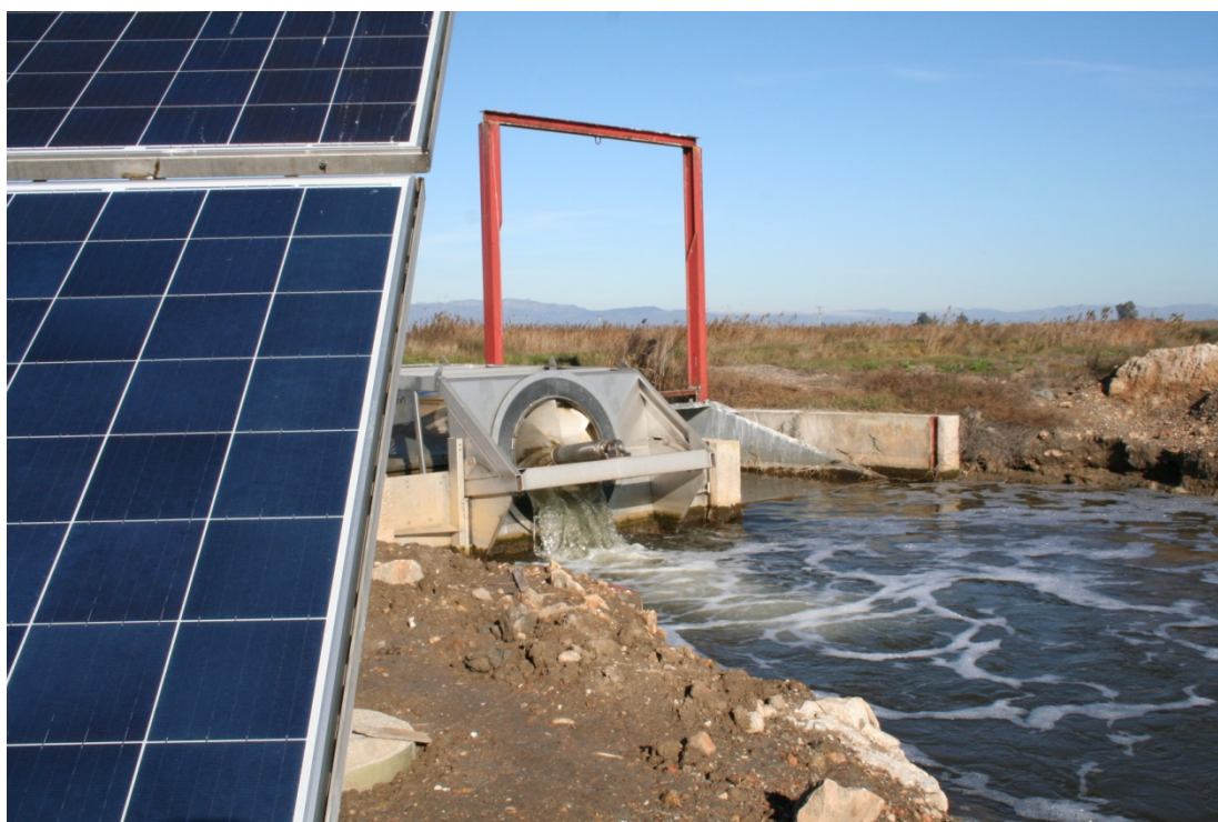
Plaques solars i sistema de bombament a la llacuna de l'Encanyissada.
