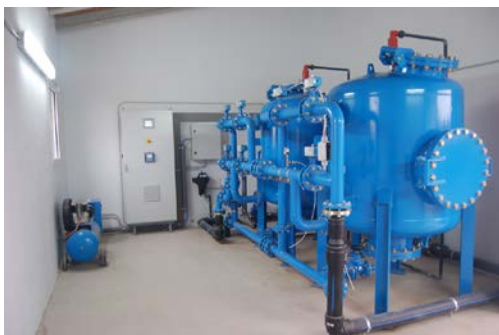
Interior d'una potabilitzadora municipal.
