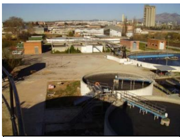
Depuradora de Martorell.
