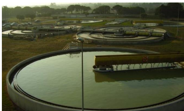
Depuradora de Cambrils, Baix Camp.
