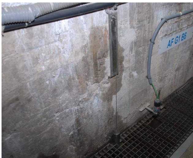
Indicador de mesura per detectar possibles filtracions.
