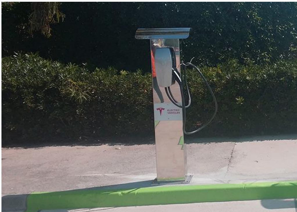
Punt de recàrrega per a vehicles elèctrics.
