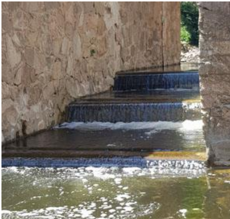
Estació d'aforament a la cua de l'embassament de Susqueda.
