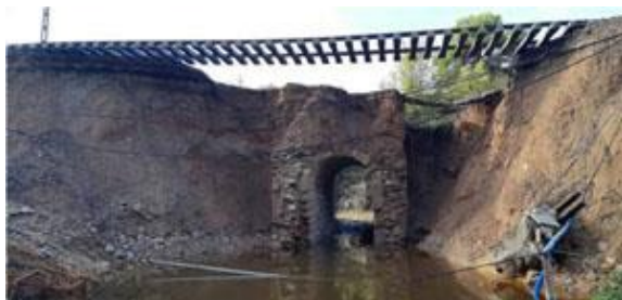
Una captació d'aigua danyada pels forts aiguats del passat octubre.
