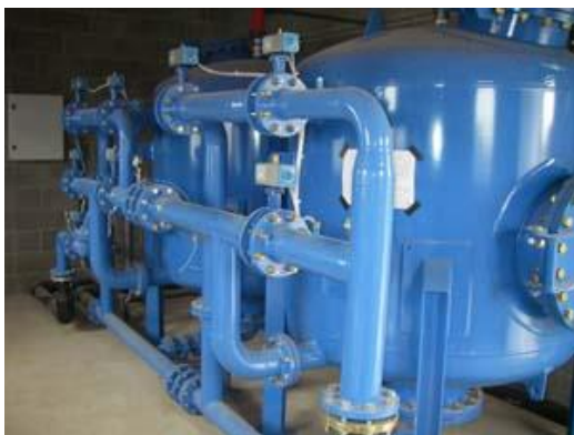
Interior d'una planta potabilitzadora (arxiu).
