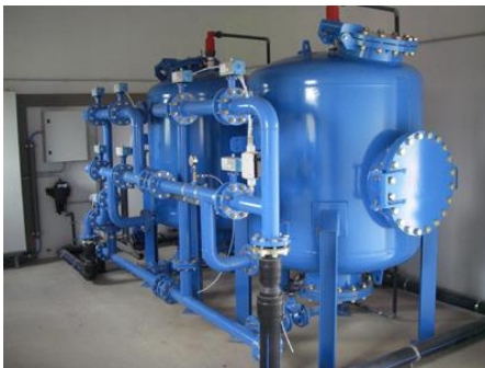
Interior d'una planta potabilitzadora municipal.
