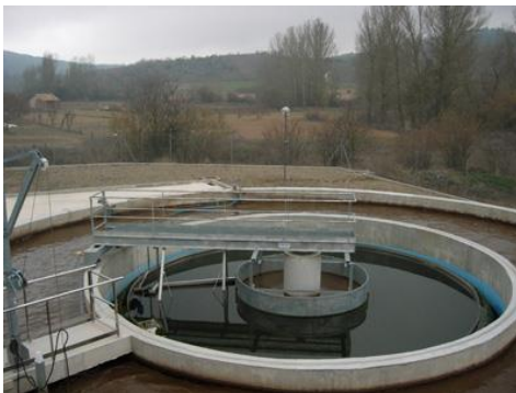
Detall d'una depuradora (arxiu).
