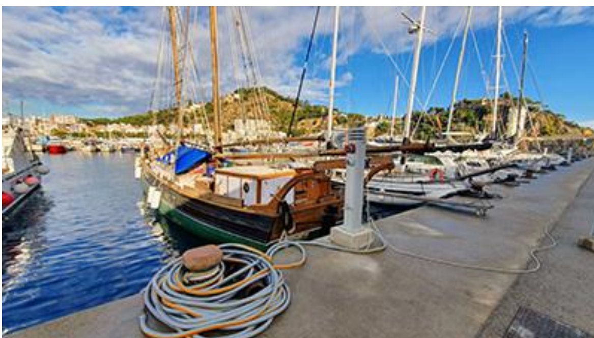
Torretes de telegestió intel·ligents al port de Blanes.
