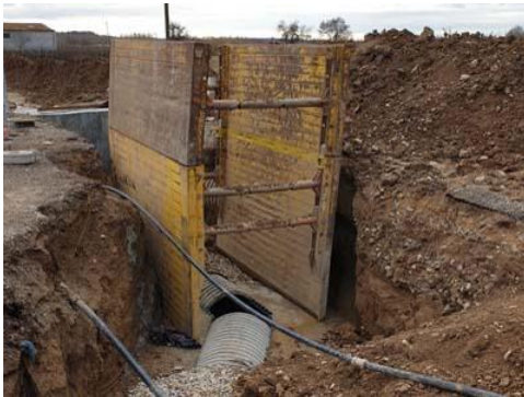
La conducció evitarà l'arribada d'aigües netes a la depuradora, optimitzant el seu funcionament.
