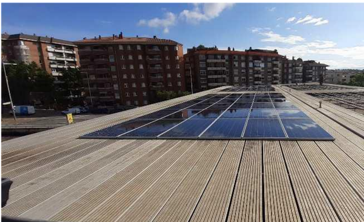
Les plaques solars instal·lades a la coberta de l'edifici del carrer dels Vergós, a Barcelona.
