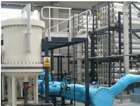
Interior d'una Estació Regeneradora d'Aigua (ERA)
