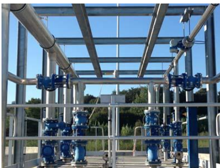
Detall d'una depuradora (arxiu).
