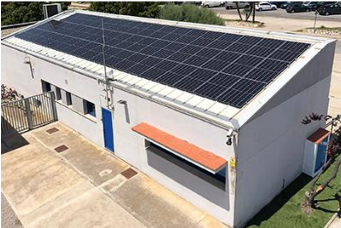
Plaques fotovoltaïques col·locades.
