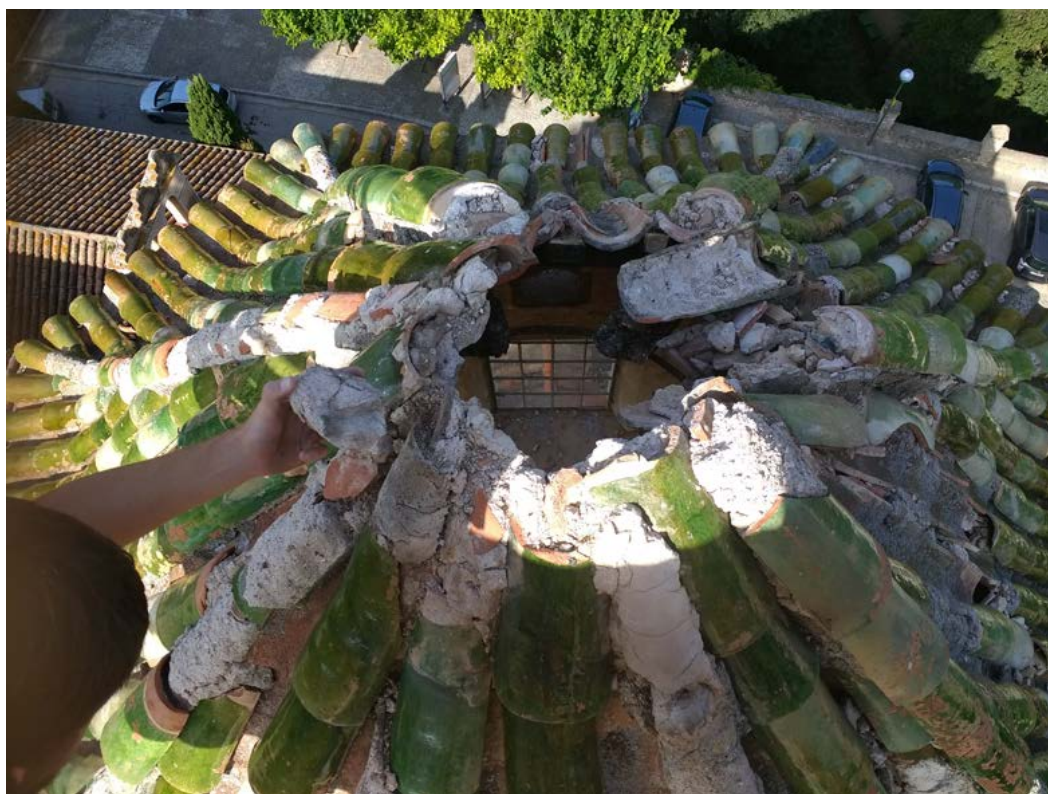
Vista de l'estat actual del badalot del Portal de l'Assumpta al Monestir de Santes Creus d'Aiguamúrcia.
