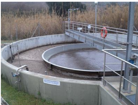
Detall del reactor biològic d'una depuradora (arxiu).
