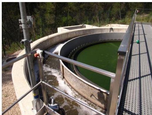
1. Detall d'una depuradora (arxiu)
