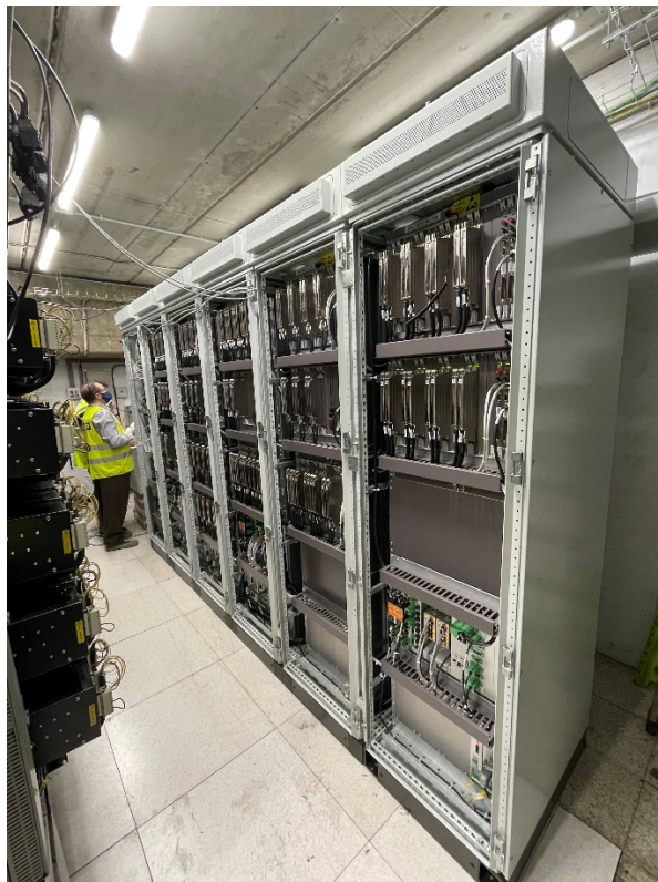
Nou enclavament a les instal·lacions de Sant Genís
