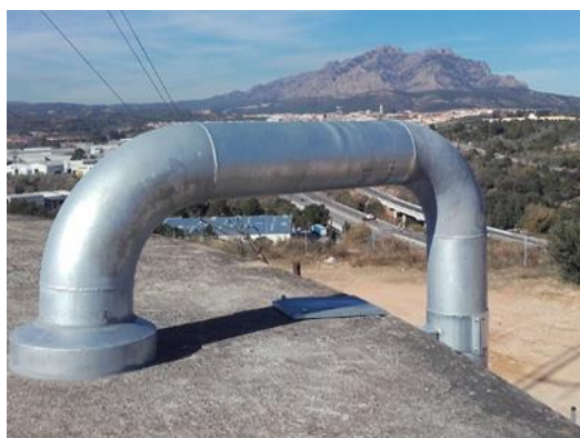
1. Detall d'una conducció per a millorar una xarxa d'abastament en alta (arxiu).
