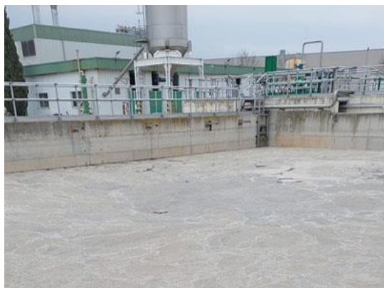
1. Dipòsit a la depuradora de Montornès que ha emmagatzemat 4.500 m3 d'aigua provinent de l'extinció de l'incendi. Font: Consorci Besòs Tordera.
