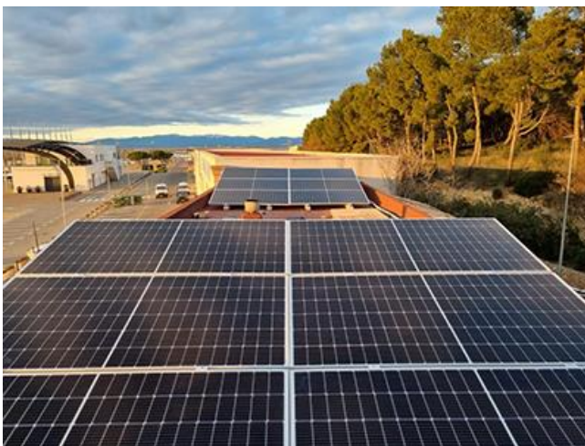
Plaques solars a les oficines portuàries.
