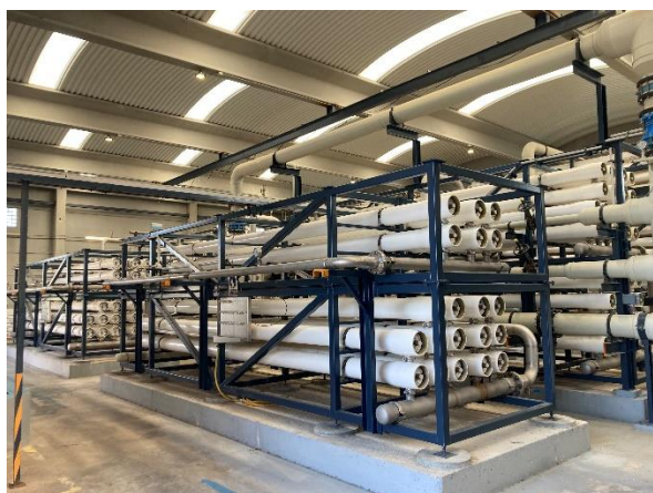
2. Interior de la planta d'osmosi inversa.
