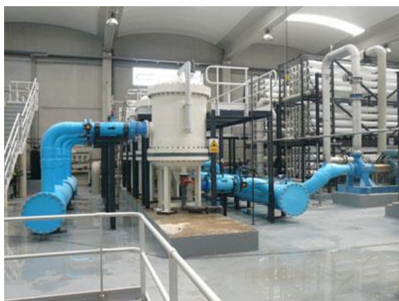
1. Interior d'una planta d'osmosi inversa, destinada a la regeneració de l'aigua depurada.
