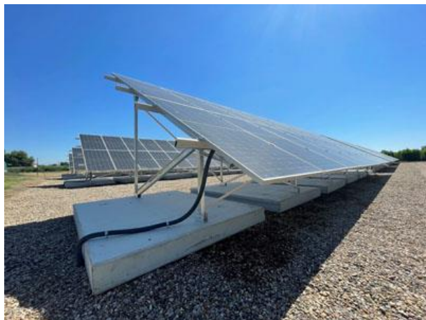
1. Detall dels panells solars que s'han instal·lat a la depuradora de Lleida, al Segrià.
