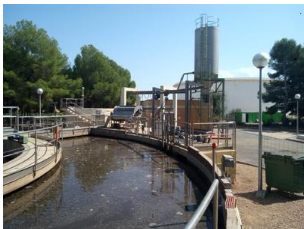
2. Detall de la depuradora de la Pobla de Mafumet.
