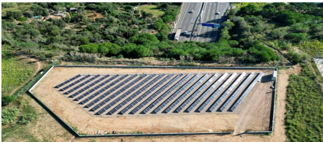
Instal·lació fotovoltaica sobre el túnel de la C-32, a Mataró
